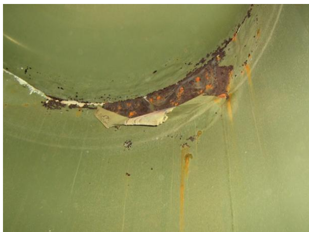
Corrosión de acumuladores de ACS
